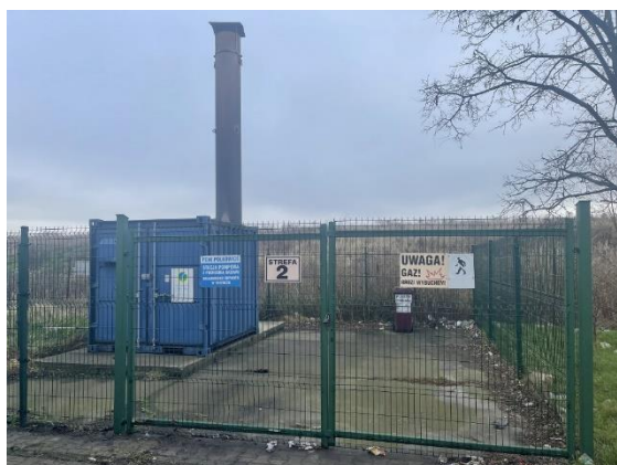
Zdjęcie 5. Stacja biogaz
