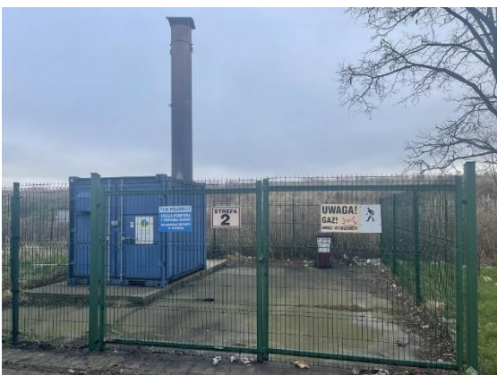
Zdjęcie 5. Stacja biogaz
